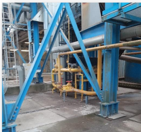
Foto 2 Gasleiding voor de droogtrommels
